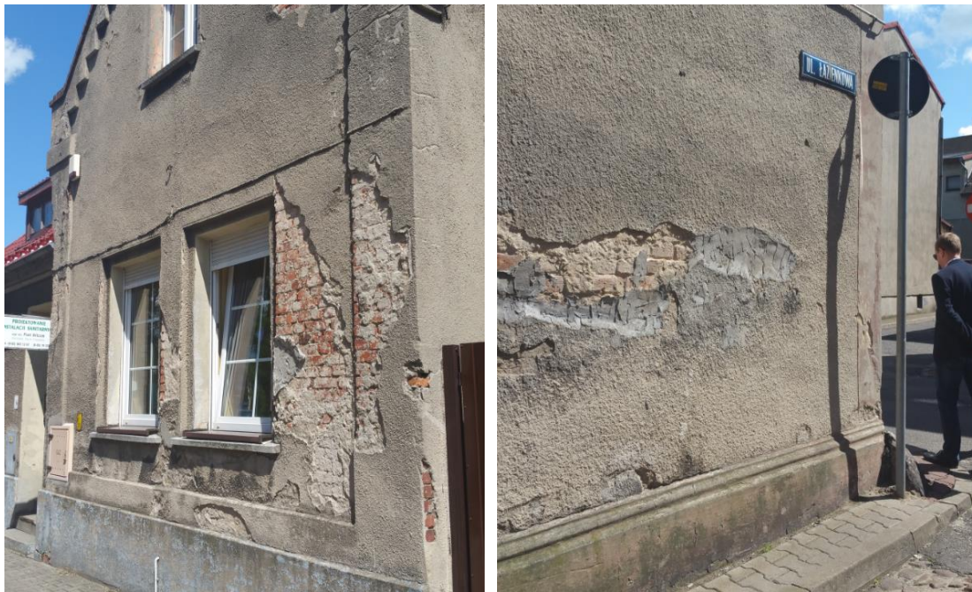
Zdjęcie 8 Zniszczona elewacja budynków mieszkalnych w centralnej część miasta
