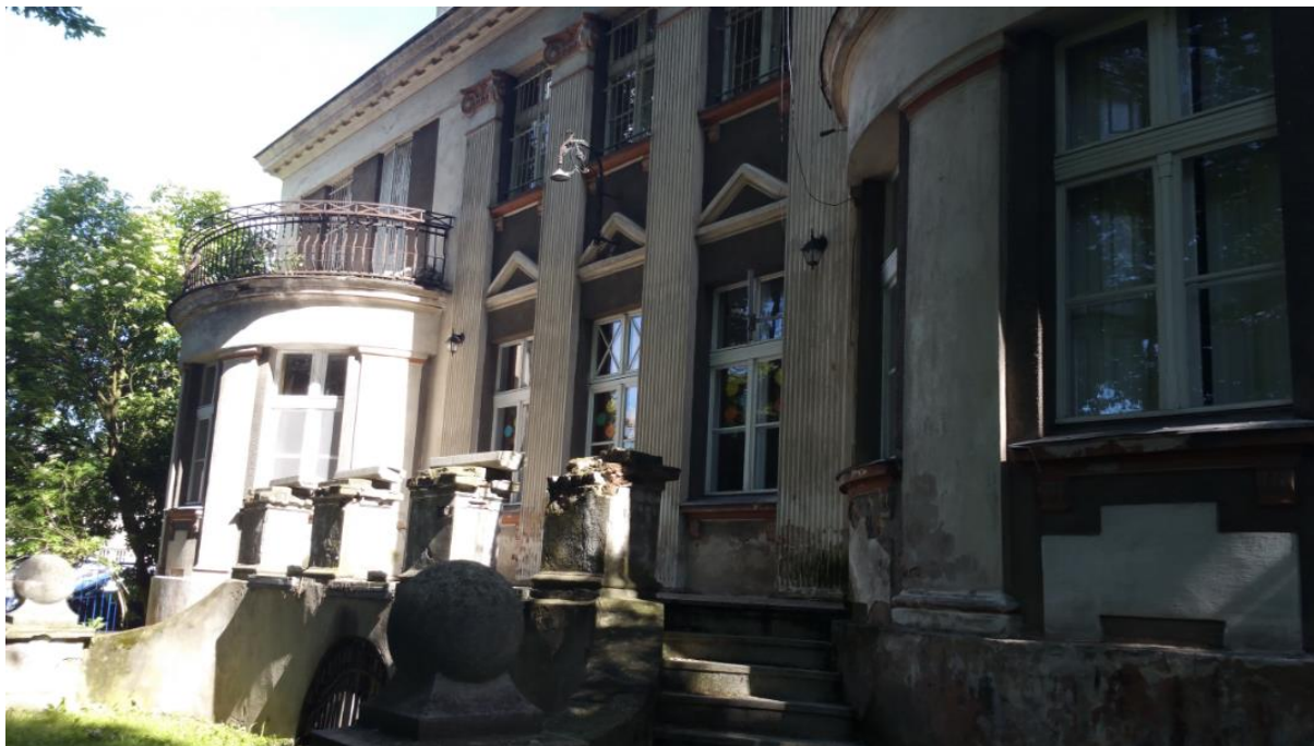
Zdjęcie 6 Zniszczona elewacja budynku Willi Starosty obecnie wykorzystywanego jako siedziba Samorządowej Biblioteki Publicznej im. Marii z Fredrów hr. Szembekowej w Kępnie
